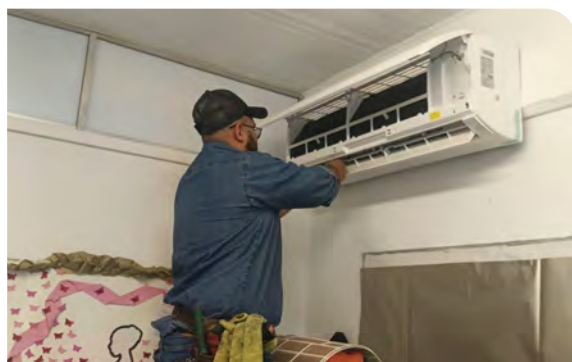
Mantenimiento de aires acondicionados
